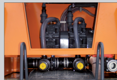
Wartungsfreundlicher Maschinenraum mit schnellem Zugang zu Computereinheit, Ventilen und Solepumpen.
