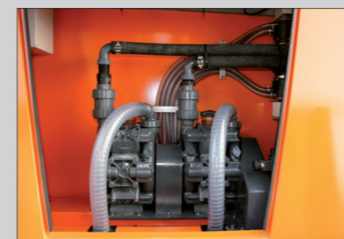
Logisch aufgebautes Solesystem mit Membranpumpe.
